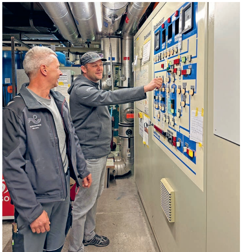
Die Schwimmbadtechnik ist eine von vielen Anlagen, für dessen Unterhalt Pius Korner mit dem Hauswart-Team zuständig ist.
